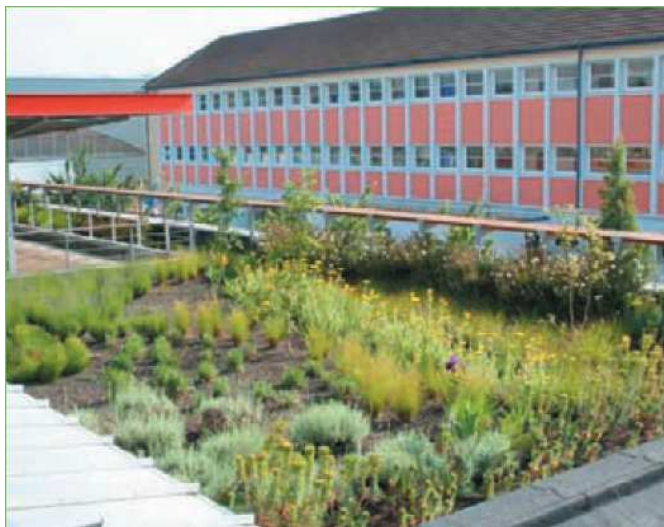
Toiture stockante végétalisée
