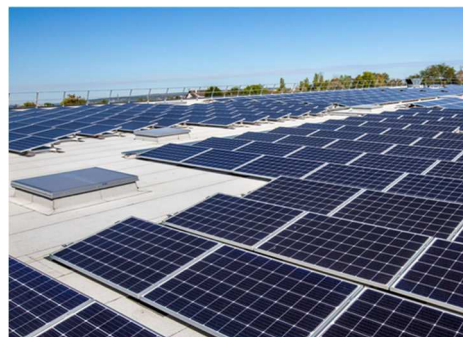
toiture équipée de panneaux photovoltaïques
